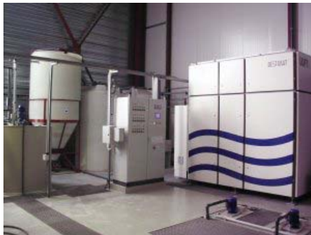
Station de récupération d'eau
